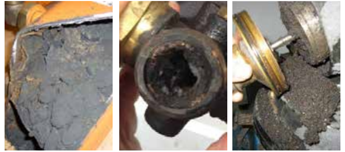
Snavsaflejringer i HVAC-udstyr
